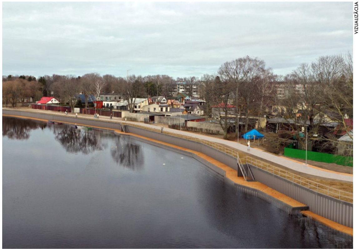
Līdz ar Lielupes krasta nostiprinājuma izbūvi tiks novērsti plūdu un krasta erozijas riski, apkārtnē tiks sakārtota un kļūs par pievilcīgu vietu dzīvošanai un atpūtai.
