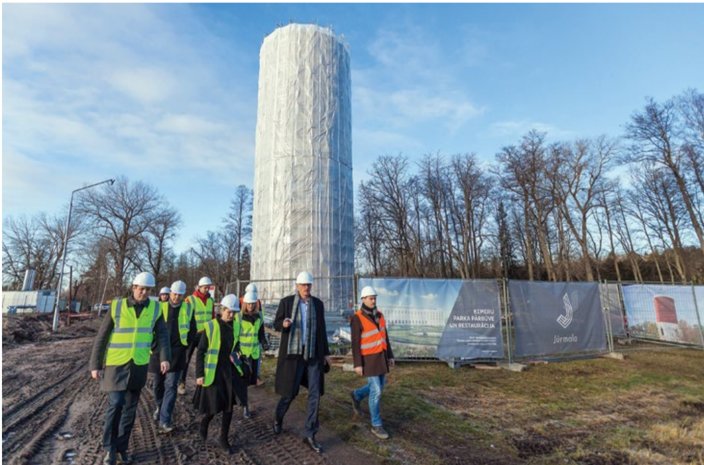
Darbu gaitu Ķemeru vērtē domes priekšsēdētājs Gatis Truksnis (attēlā centrā) kopā ar pašvaldības Attīstības pārvaldes un būvdarbu veicēja "RERE BMW" pārstāvjiem. Attēlā pa labi: ūdenstornja izbūves iekšdarbi.
