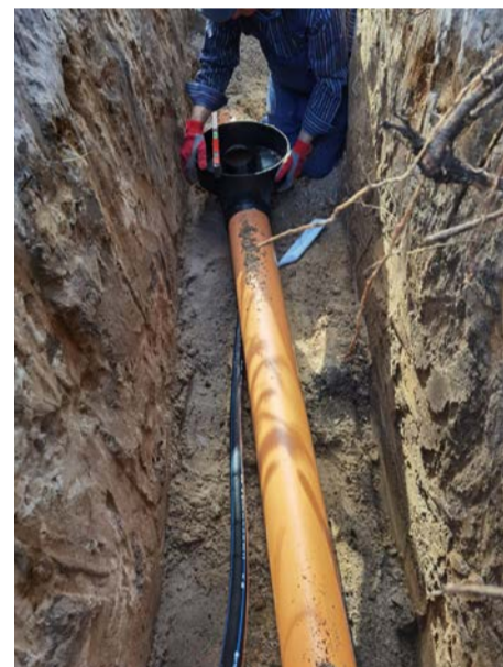
SIA "Jūrmalas ūdens" izbūvē ūdenssaimniecības tīklu līdz nekustamā īpašuma robežai. Nekustamā īpašuma īpašnieks savā īpašumā veic pievada izbūvi centralizētajam tīklam.
