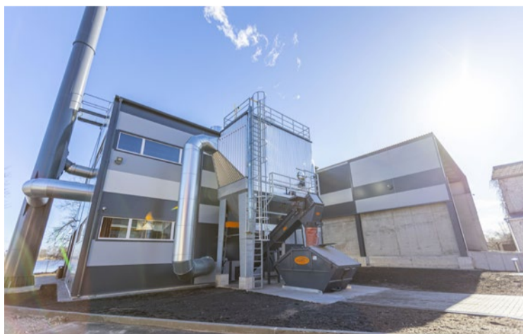
Jaunajā šķeldas katlumājā uzstādīts Austrijas uzņēmumā ražots apkures katls ar dūmgāzu kondensācijas iekārtu, kas dūmgāzu attīrīšanas procesā ļauj iegūt papildu siltumenerģiju.
