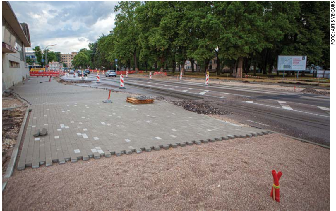
Apjomīgi būvdarbi notiek Dubultos, kur tiek veikta krustojuma pārbūve – papildu braukšanas joslas izveide, jaunu autosstāvvietu izbūve un regulējamas gājēju pārejas izveide.
